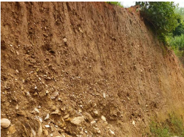
照片3-2 坡面出露残坡积粘性土
