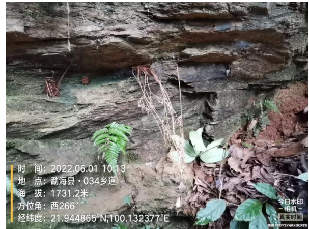
照片3-3 坡脚出露基岩
