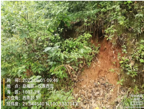
照片3-2 坡面出露残坡积粘性土
