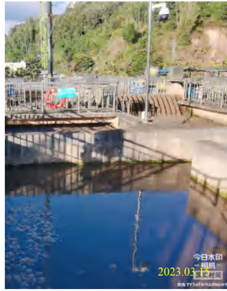
现有污水处理（好氧池）
