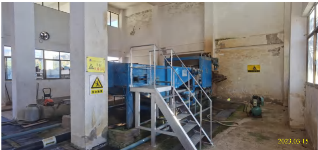
项目现有污泥浓缩脱水机
