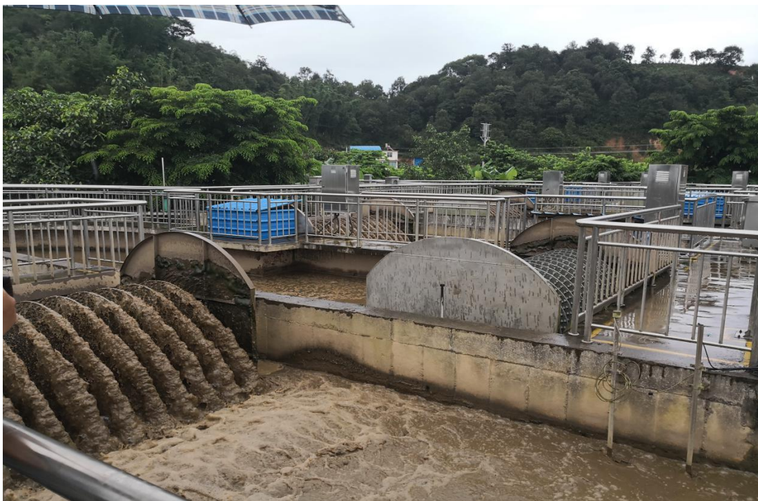
1#、2#氧化沟（生化处理池）同时投入运行
